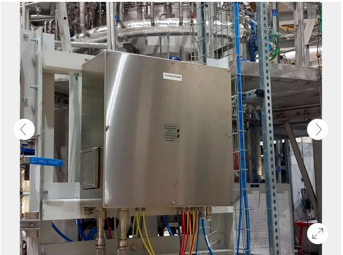
Integrierter Steuerkasten. (Bild: Iter)
